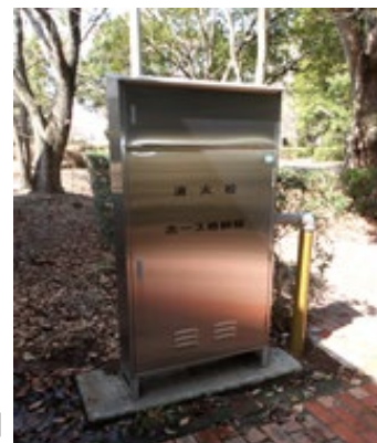
【屋外消火栓外観】
