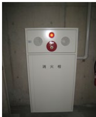
【屋内消火栓外観】
