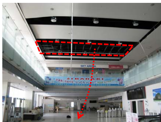
写真1 東日本大震災での天井脱落被害例
