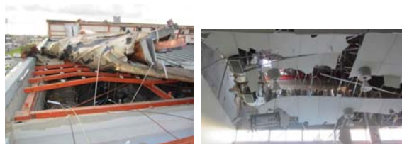
図3 鉄骨造の文教関連施設の屋根ふき材と天井材の被害
