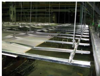
写真5 耐風圧クリップ使用でのボード落下
