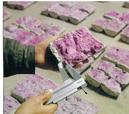
コンクリートの断面にフェノールフタレン液を噴霧して中性化深さを測定する
