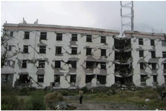
写真13 1階が崩壊した学生寮(2008年、四川省映秀)
