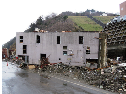
図1 津波による転倒
