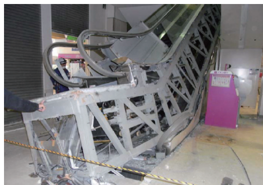
図3 エスカレーターの落下 16)
