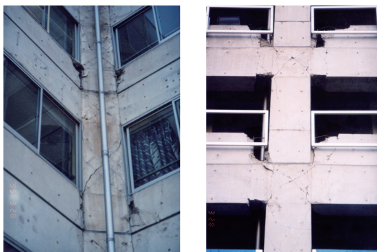
(a)柱のせん断破壊や損傷 (b)梁や柱梁接合部の損傷
