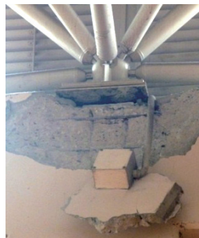
図10 体育館の被害
