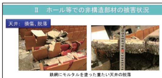
図 1 熊本地震での被害 4)
