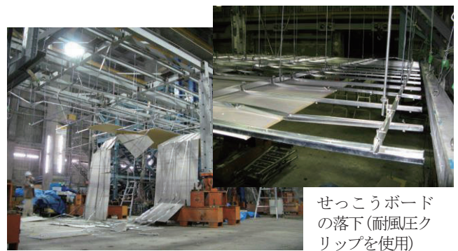
クリップの外れによる天井面の落下
