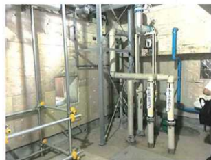
内観(ポンプ室)
