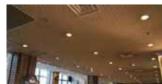
写真：LED 照明(ロビー照明)
