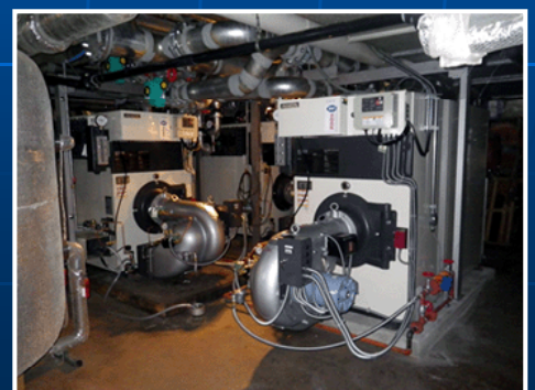
▲更新後 温水ヒーター3台
