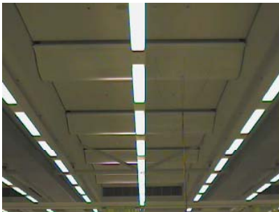
放射併用吹出パネル 設置状況
