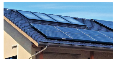
太陽光発電システム、空気集熱式ソーラーパネルを採用(事例2)
