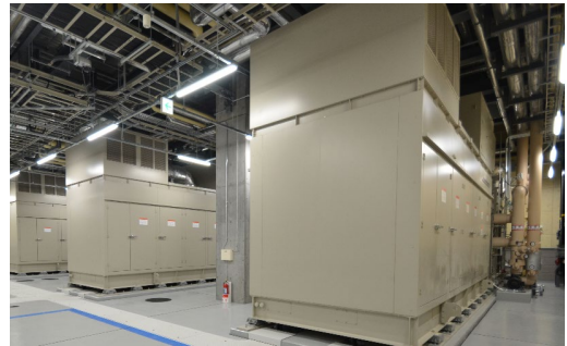
ガスエンジンCGS
