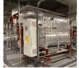
排熱投入型冷温水発生機
