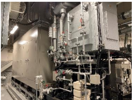
外来棟CGS (370kW×1台)
