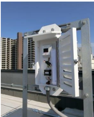
▲屋上の測定器
