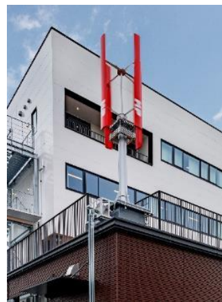
▲小型風力発電設備
