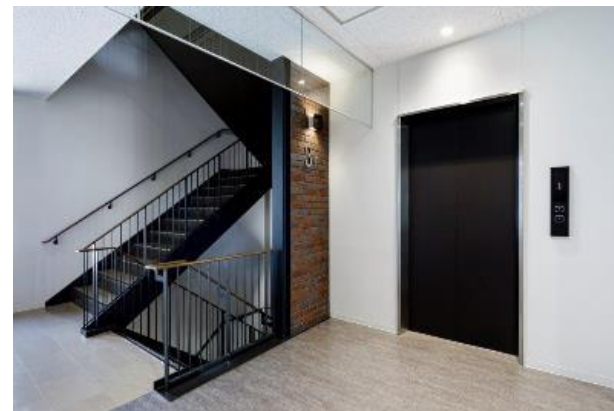
▲防火戸のない階段室
