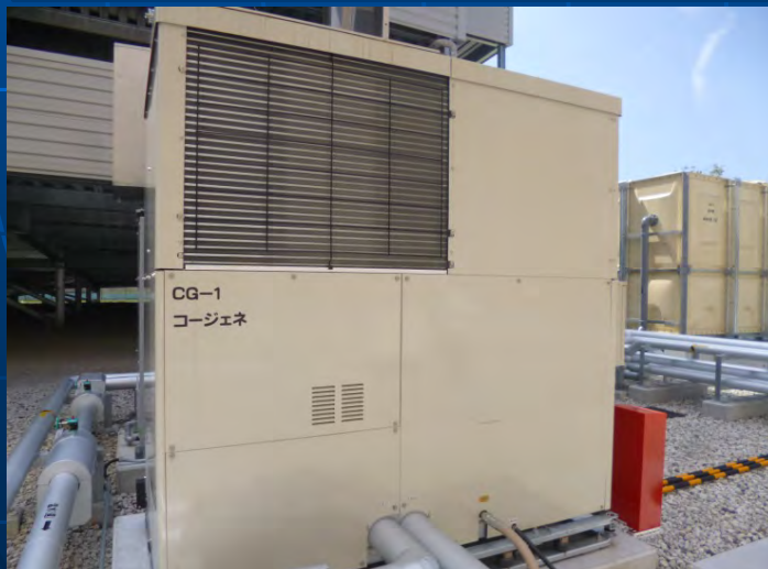
ガスコージェネレーションシステム (スポーツクラブネサンス広島東千田設置)
