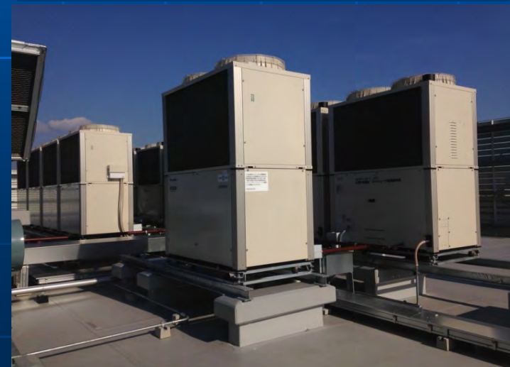
ガスヒートポンプエアコン (広島大学東千田キャンパス設置)
