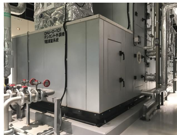
見せる機械室のデシカント外調機
