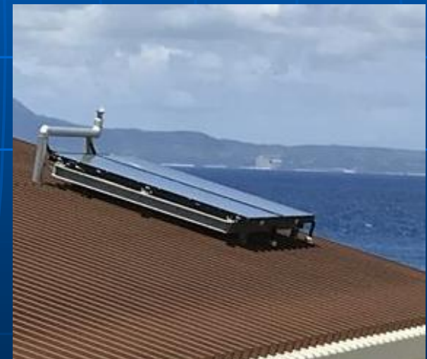
LNGサテライト設備用建屋の屋根に太陽熱パネルを設置
