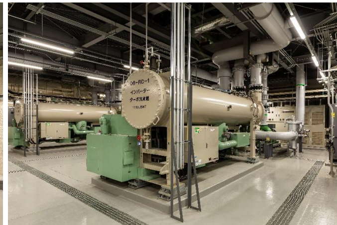
ターボ冷凍機
